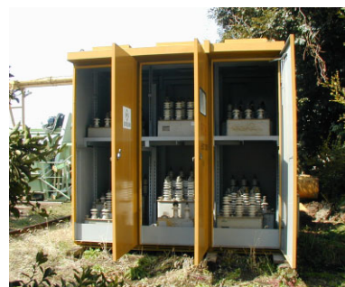
高圧コンデンサの保管状況
