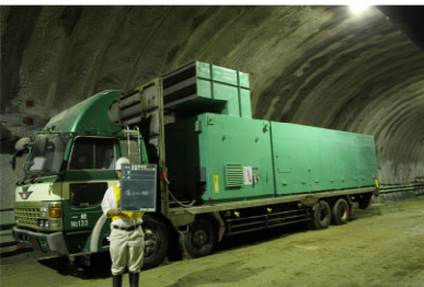
坑内の電気集塵機
