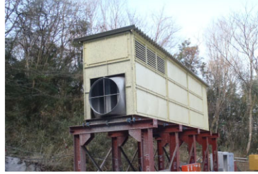
防音パネルで覆った送風機
