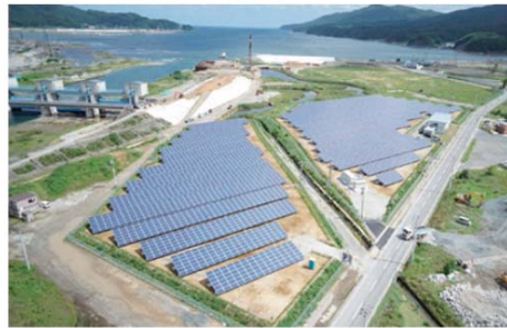
津軽石発電所（宮古発電合同会社）
