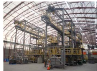
浪江主灰封入機械装置プラント
