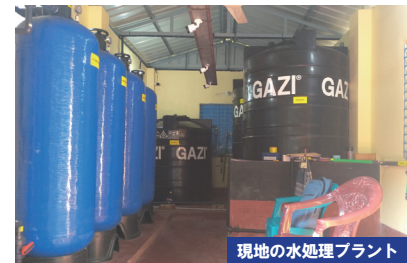
現地の水処理プラント
