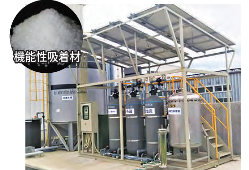
水処理実験設備
