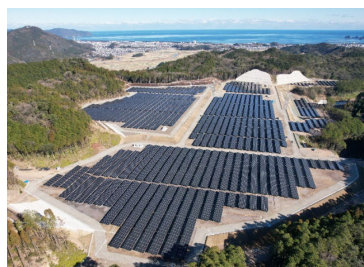
延岡くじら池太陽光発電所(宮崎県延岡市)
