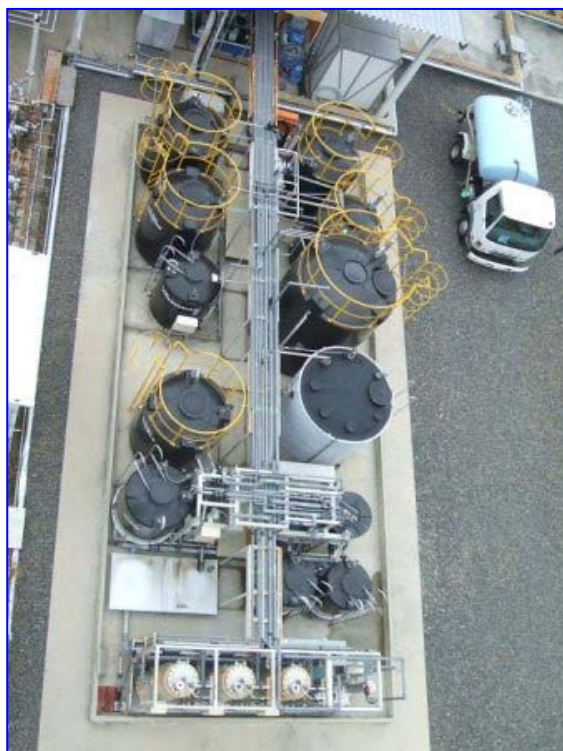
石炭火力発電脱硫排水処理実証プラント
