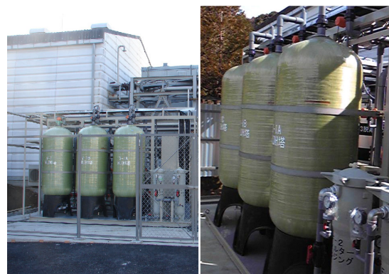
排水処理ラインに組み込まれたNLDH塔
