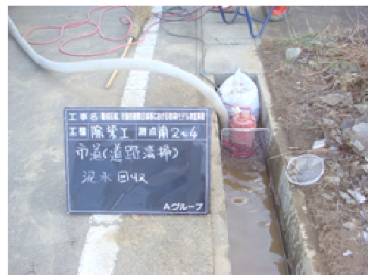
同左回収ポンプ
