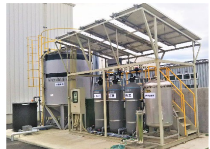
つくば未来センターにある水処理プラント
