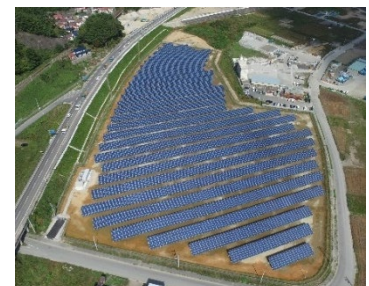
田老太陽光発電所 発電能力2,367kw パネル9,282枚
