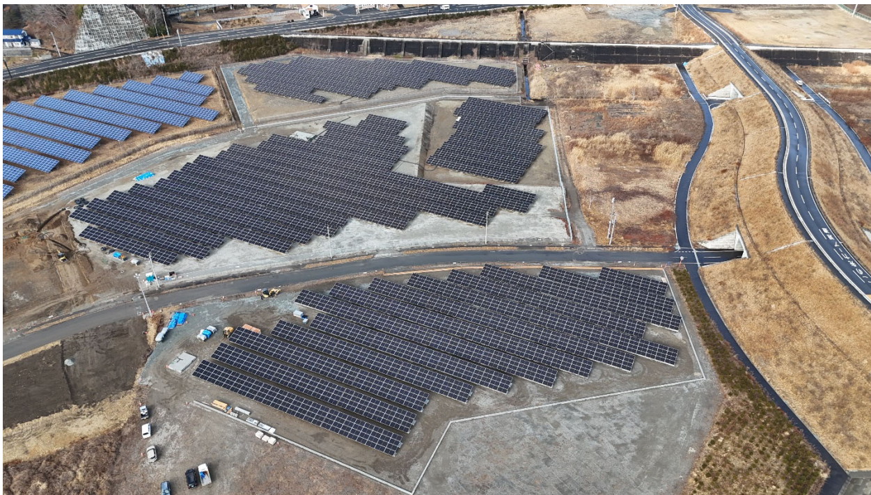
太陽光パネルの設置が完了した夜間連系太陽光発電所（2025年1月21日撮影）
