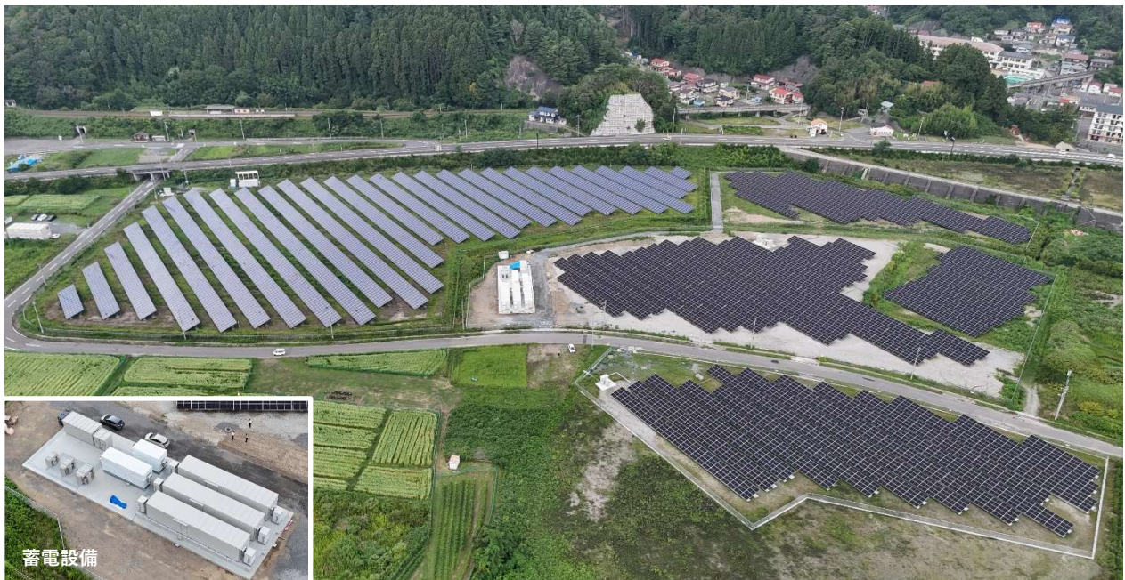
蓄電設備（中央・左下）が設置された夜間連系太陽光発電所（2025年8月20日撮影）
